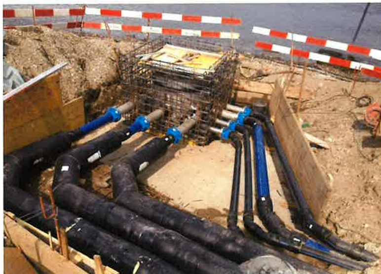
Foto 2: Condotte in partenza dal pozzo a lago; sulla sinistra le tre condotte isolate termicamente di adduzione dell'acqua pompata (foto durante il cantiere nell'aprile 2014).
