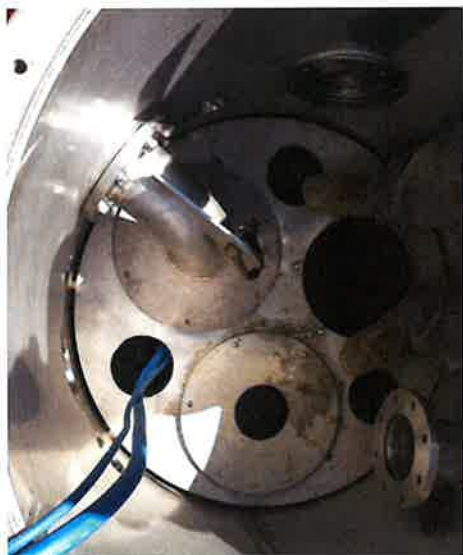
Foto 1: Struttura inox di chiusura e fissaggio delle pompe nel pozzo (foto durante l'installazione della prima pompa)
