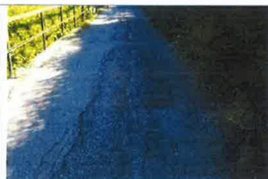
Pavimentazione in cattivo stato di conservazione
