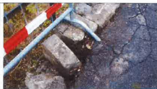
Dettaglio del cordolo esistente pericolante
